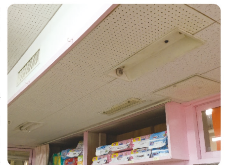
千葉県乳児院を視察。写真は雨漏りが発生した天井部分。
